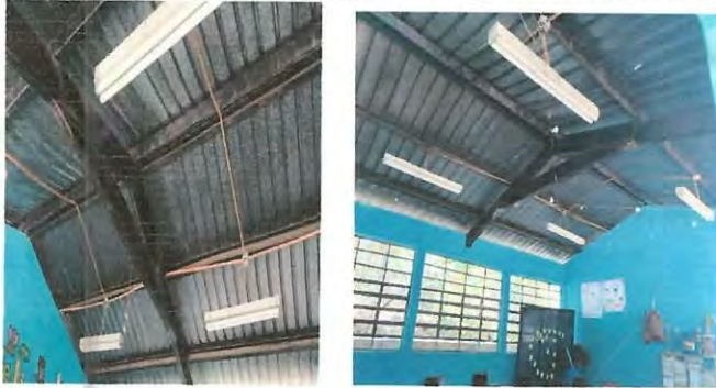
Foto1: Se realizará cambio del sistema eléctrico en todo el centro educativo que esta en malas condiciones.
